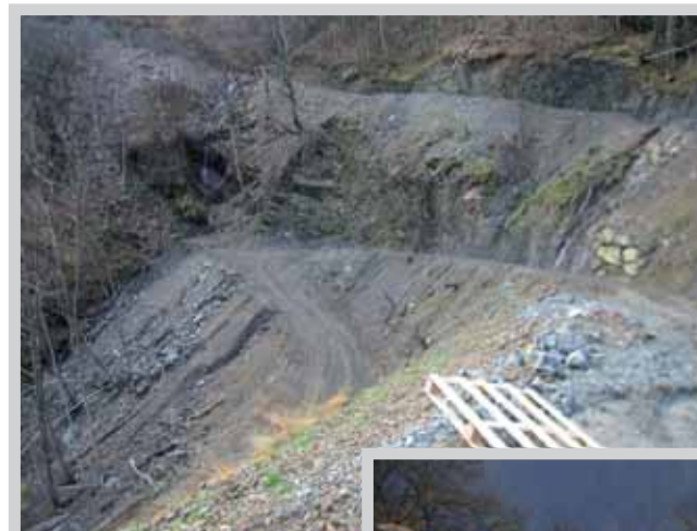
Fig. n.2. - Sbancamento e destabilizzazione di versante vallivo per strada d'accesso a prese idroelettriche nell'alto Lario, (foto G. Ciapessoni – Comitato Acque Comasche)
