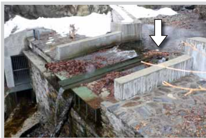
Fig. n.1: By pass per rilascio DMV su griglia d'impianto pre-esistente a captazione totale, realizzato con canaline intasabili da pietrisco e fogliame (vedasi freccia)
